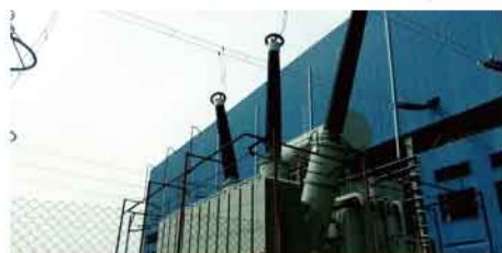
Индия: трансформатор 420kV 60MVA
