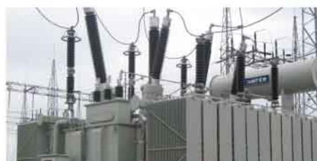
Эквадор: силовой трансформатор для CELEC S.A
