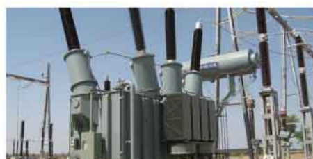
Буркина-Фасо: силовой трансформатор для Fordum
