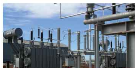
Австралия: трансформатор 132kV для ВНР
